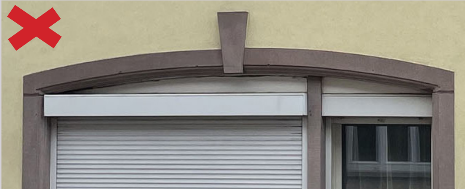
Le caisson de volet roulant en saillie perturbe la lecture de l'ouverture notamment par sa forme qui rompt avec l'arc segmentaire du linteau.
