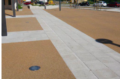
Les revêtements liés sont onéreux. Leur efficacité est limitée dans le temps car leurs cavités se bouchent avec les particules.
