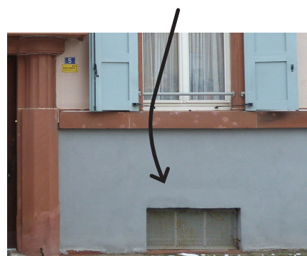
Au niveau du soupirail, derrière une grille obstruant l'ouverture de ventilation
