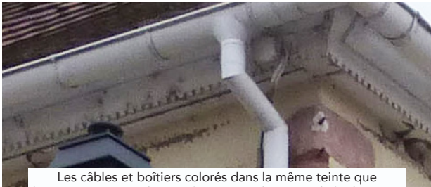
Les câbles et boîtiers colorés dans la même teinte que la rive et masqués derrière les égoûts du toit et de la descente
