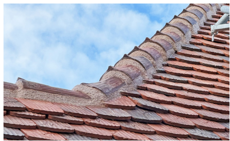
Les tuiles de faîtage et les tuiles de rives sont scellées au mortier.
